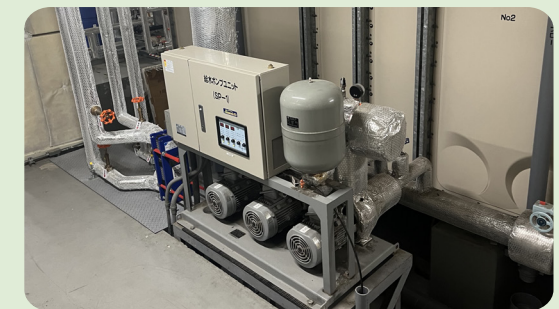
加圧給水ポンプ
