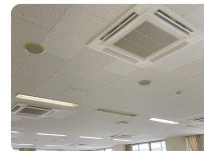
GHP室内機 / 照明
